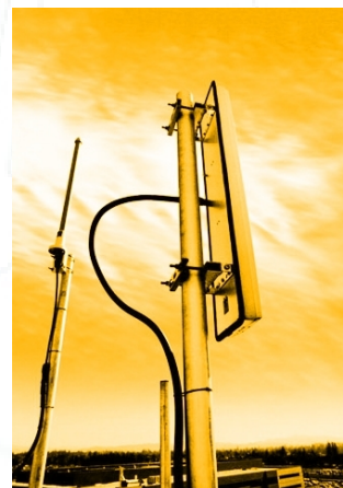
Une station de base WiMAX
