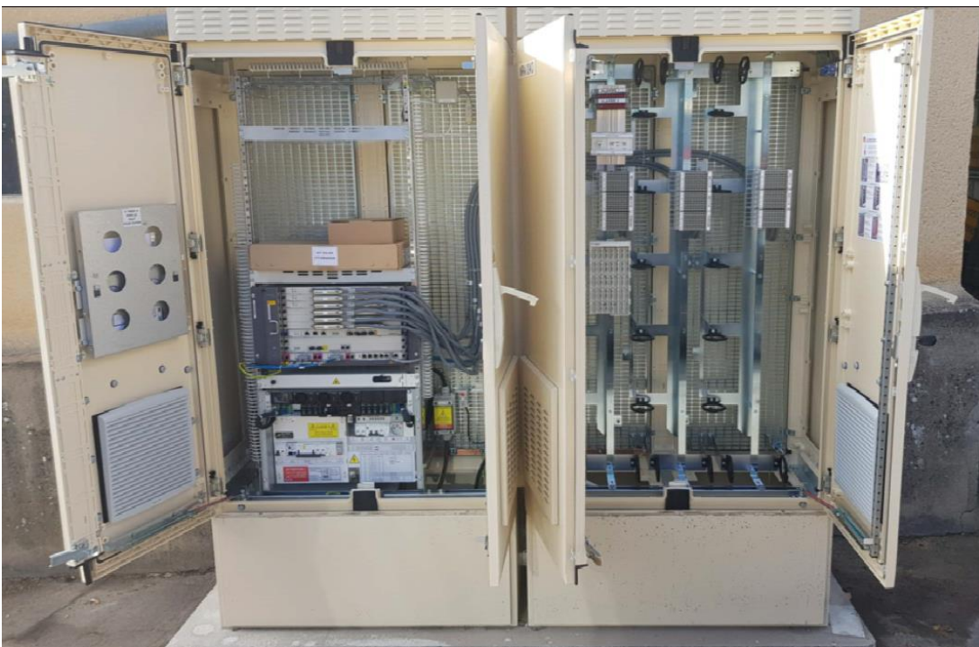
Arquian : Armoire de montée en débit ADSL
